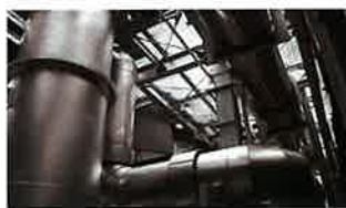
プラント配管
